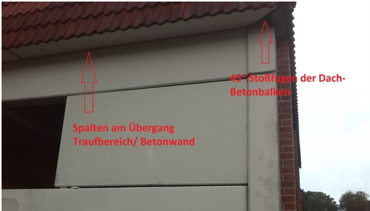
Abb. 1.7 Beispiel 3 für ein potenzielles Spalten- Winterquartier im Außenbereich des Parkhauses. Auch die Stoßfugen zwischen den aufrechten Betonelementen werden verschlossen.
