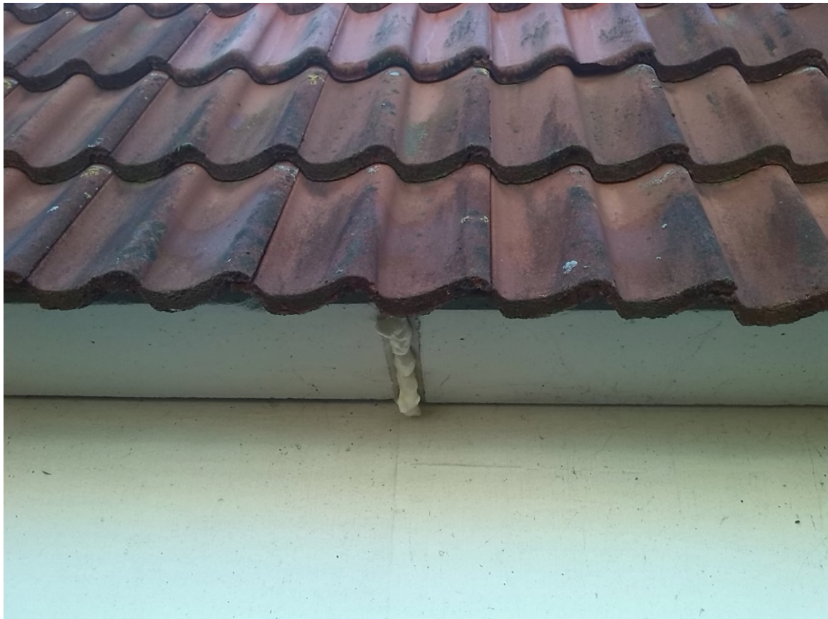
Abb. 4.1 Beispiel einer mit Bauschaum verfüllten Betonfuge am Parkhaus in Husum.
