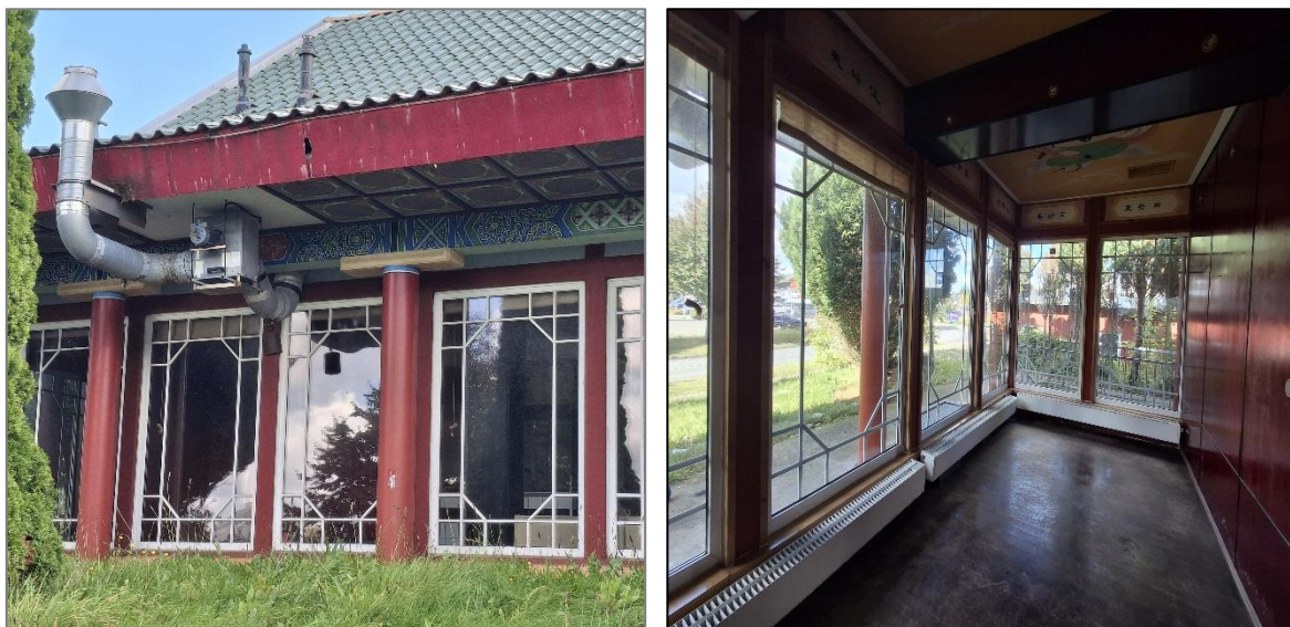
Abb. 2.4 Links: Blick auf die westliche Front des Restaurantgebäudes mit einem Loch (Einflugsmöglichkeit) im Dachkasten, Blickrichtung Ost. Rechts: Innenbereich des ehem. Restaurantgebäudes, Blickrichtung Nordwest (Fotos: J. Metternich, 23.09.2025).
