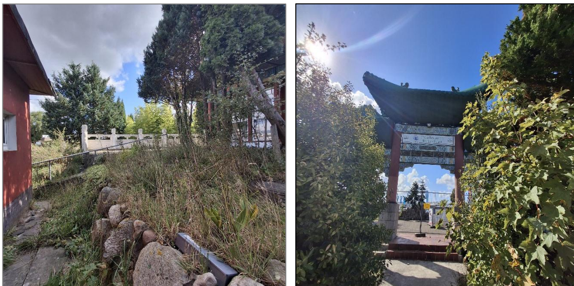
Abb. 2.12 Links: Verwilderter Bereich zwischen Nebengebäude und Hauptgebäude, im Hintergrund die Terrasse und die Parkanlage, Blickrichtung Ost. Rechts: Blick aus der Parkanlage auf das Bauwerk des Eingangsbereiches der Parkanlage, welches aufgrund seines Zustandes mit einem Netz abgesichert ist, Blickrichtung Südwest (Fotos: J. Metternich, 23.09.2025).
